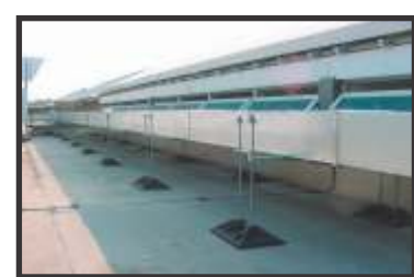
Fixations des conduites
